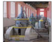
Des visites de la centrale hydroélectrique de Kembs seront proposées plusieurs week-ends en juillet et août. Photo L'Alsace/S.S.P.
